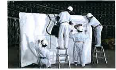
写真11. 外水槽側のセッティング
